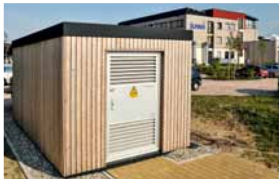
Die Trafostation am juwi-Firmensitz in Wörrstadt stammt von Isoblock.
